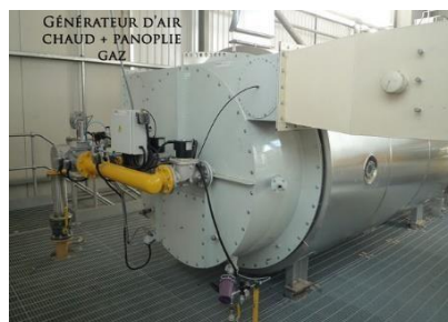
Figure 9: image d'un générateur thermique
